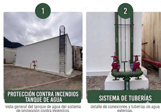
Fotografías 1 y 2 Tanque de agua del Sistema de Protección Contra Incendios
