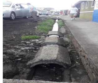
Distrito Santo Domingo, vertido de aguas residuales en alcantarillado pluvial
