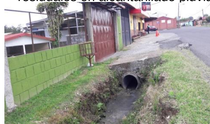
Distrito Pará, vertido de aguas residuales en alcantarillado pluvial
