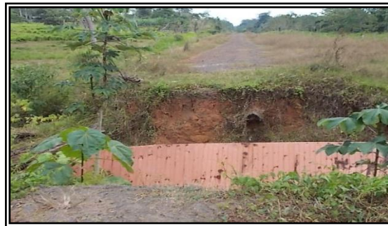
Imposibilidad de acceso por ausencia de infraestructura.
